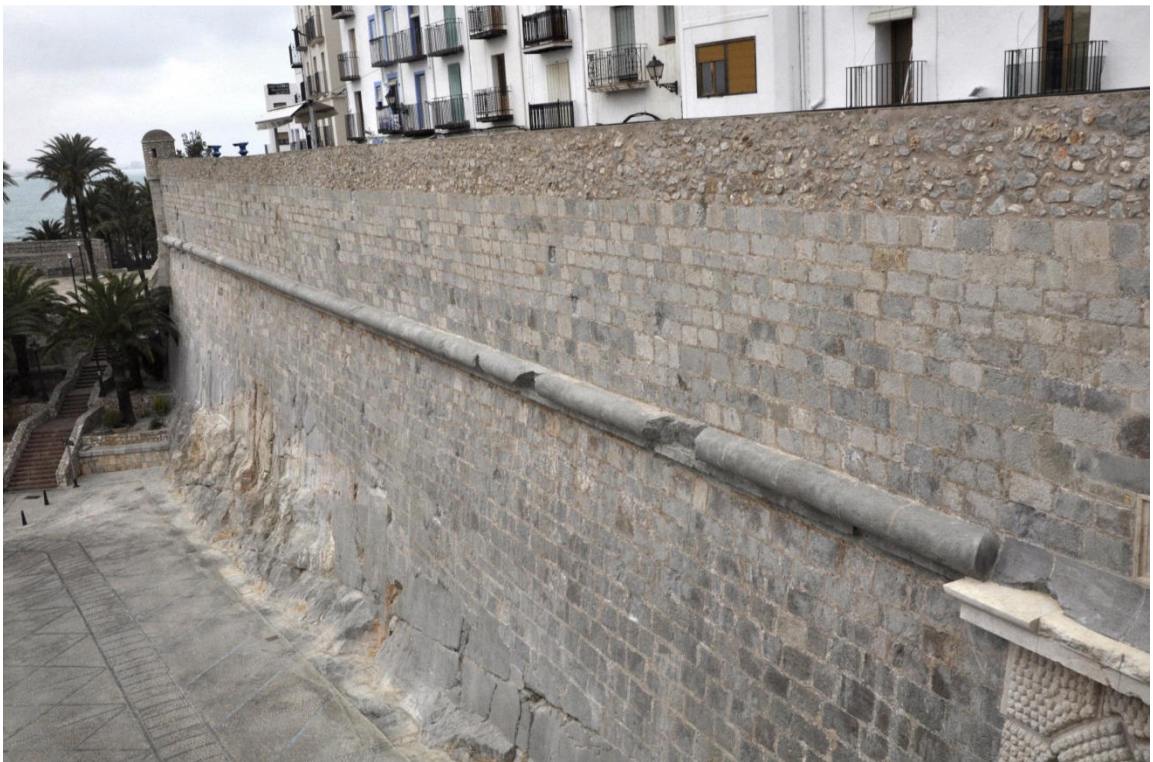
Figura 19 y20 .- Frente de la batería del Olvido antes y después de la restauración
